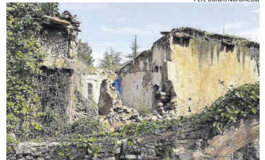
Esfondrament de la paret de la masia.
